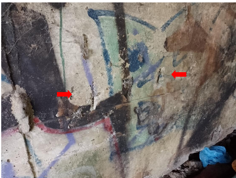
Figura 18 - armaduras expostas na cortina
