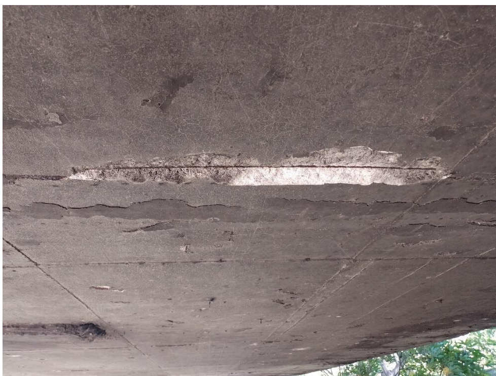
Figura 32 - armadura exposta na laje inferior do caixão
