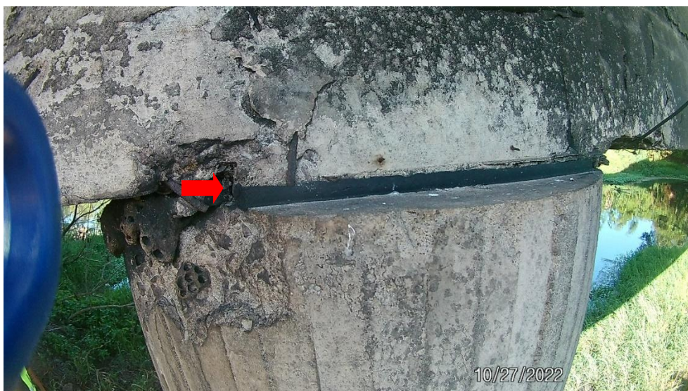
Figura 10 - aparelho de apoio esmagado e queimado no P7
