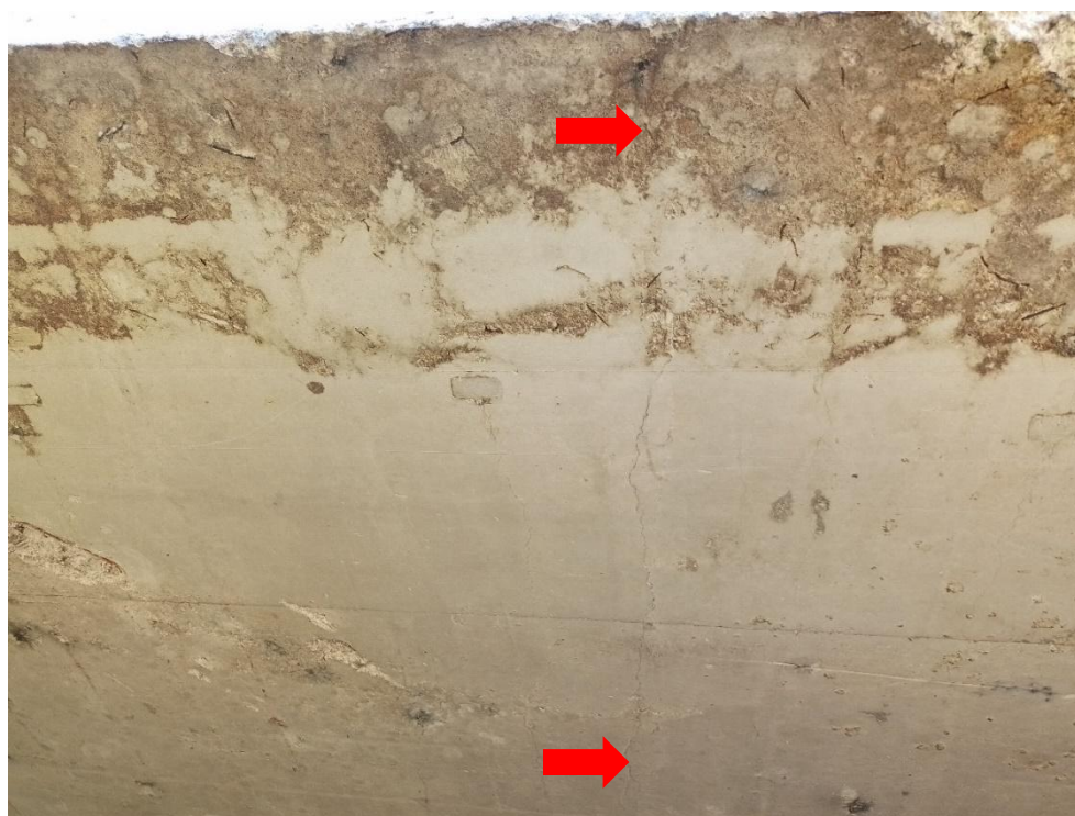
Figura 22 - a laje inferior do caixão possui fissuras que se estendem por toda a sua seção, em diversos pontos do vão
