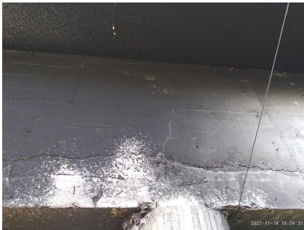
Figura 27 - marcas de fuligem e concreto segregado próximo ao pilar P07
