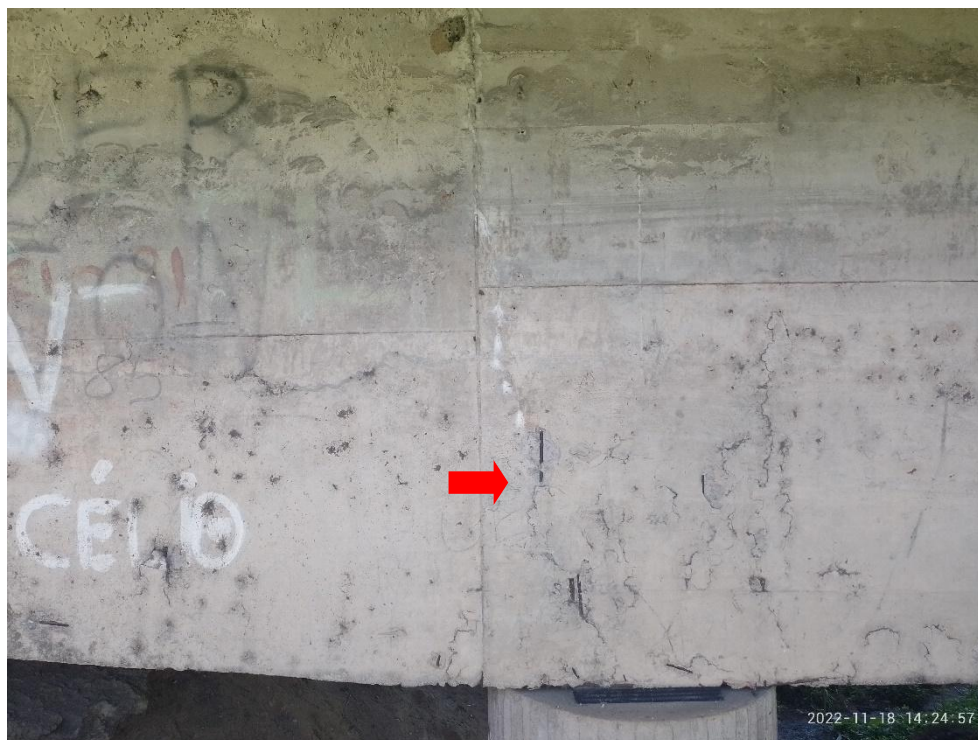
Figura 15 - armadura exposta sobre o pilar P09
