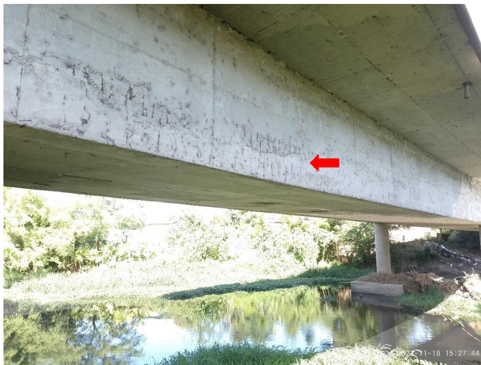
Figura 37 - armaduras expostas na parede do caixão do vão central
