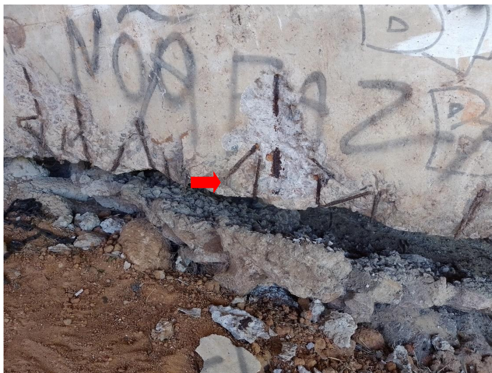
Figura 16 - caixão, junto ao E2 - armaduras expostas com perda de seção
