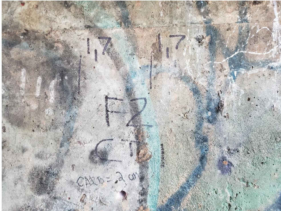
Figura 50 - Ensaio de carbonatação - Carbonatação = 2cm
