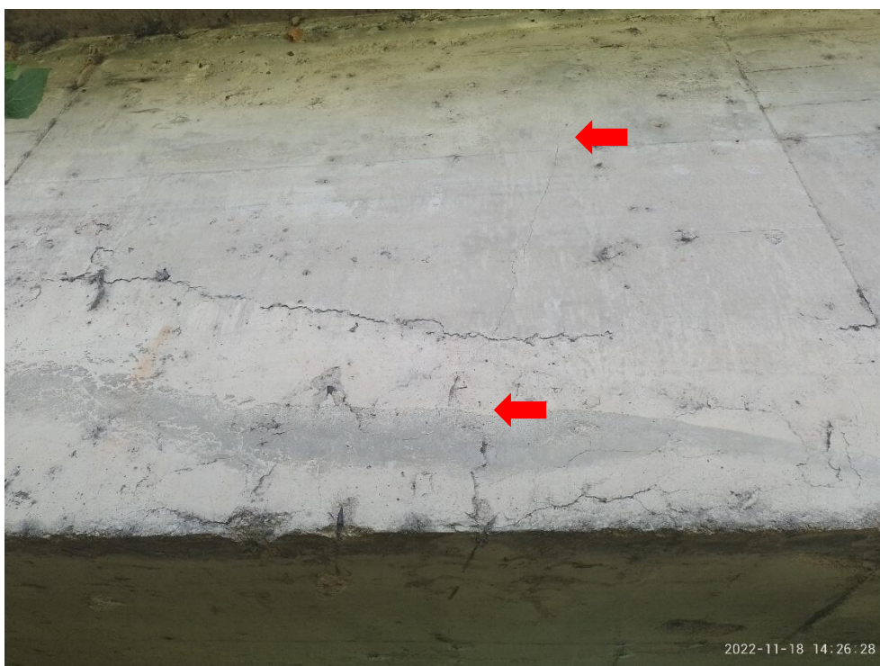
Figura 34 - fissura observada na parede do caixão, próximo ao centro do vão 3
