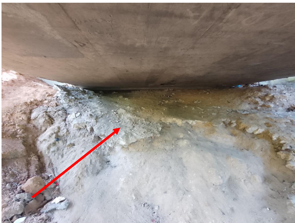
Figura 5 - contenção danificada no E2
