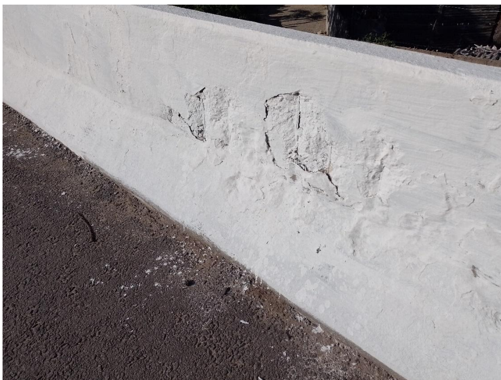
Figura 40 - concreto degradado e armadura exposta no guarda rodas
