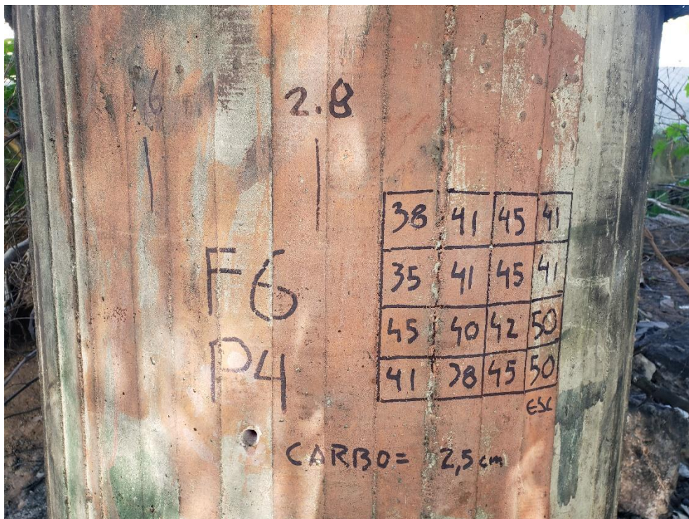
Figura 62 - Ensaio de carbonatação - Carbonatação = 2,5cm Ensaio de Esclerometria - Resultado médio = 42,4Mpa
