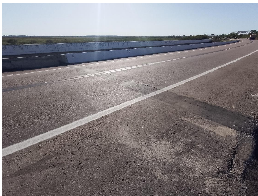
Figura 38 - sem junta de dilatação no encontro E1
