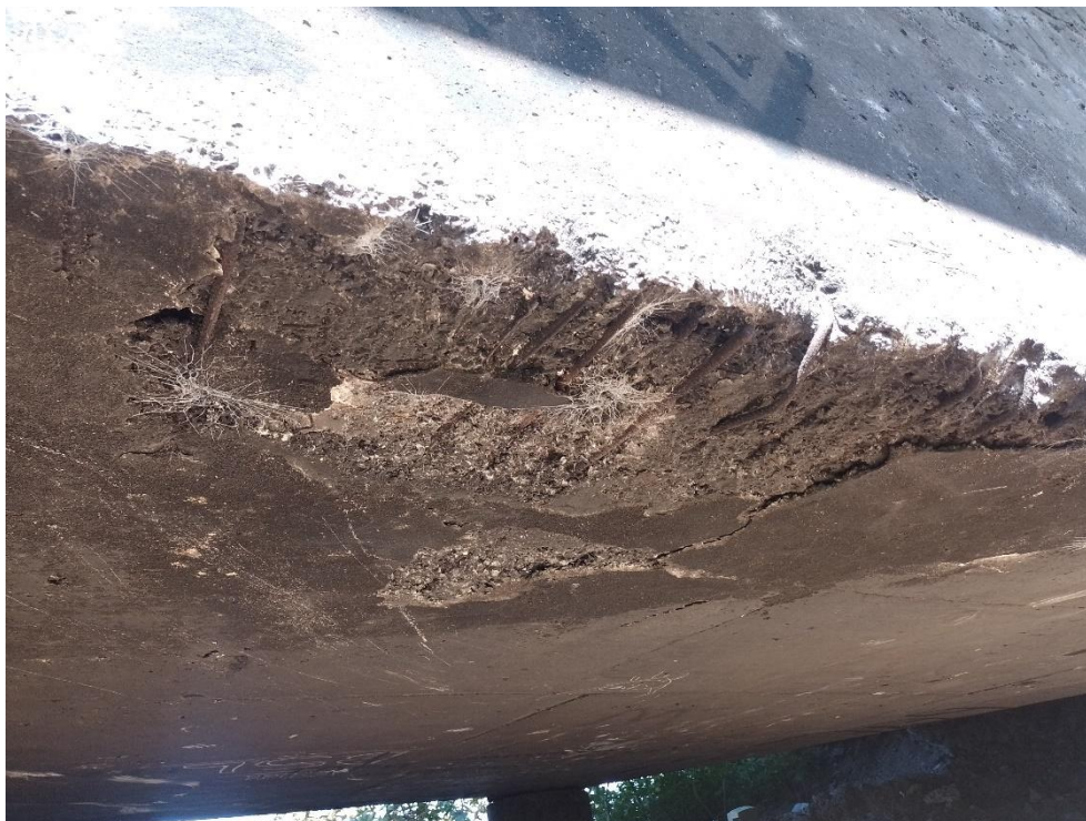
Figura 31 - armadura exposta na laje inferior do caixão
