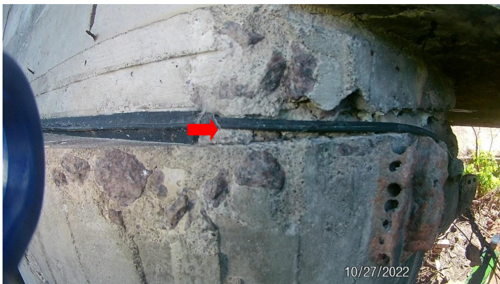
Figura 9 - aparelho de apoio esmagado, Neoprene rompido no P8
