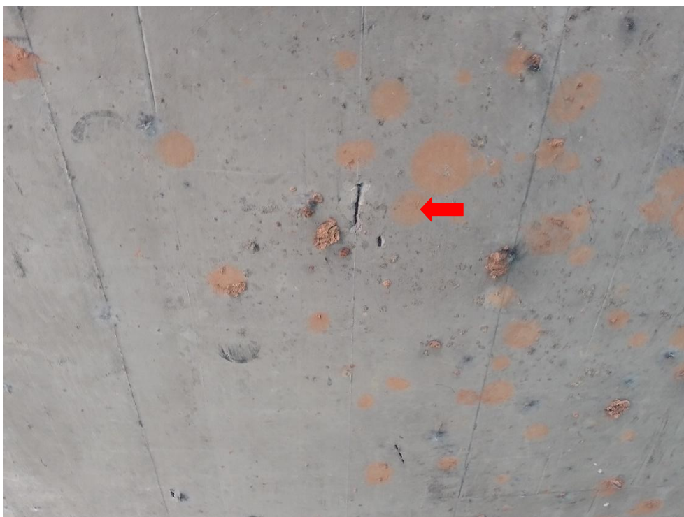
Figura 19 - fissuras na laje inferior do caixão
