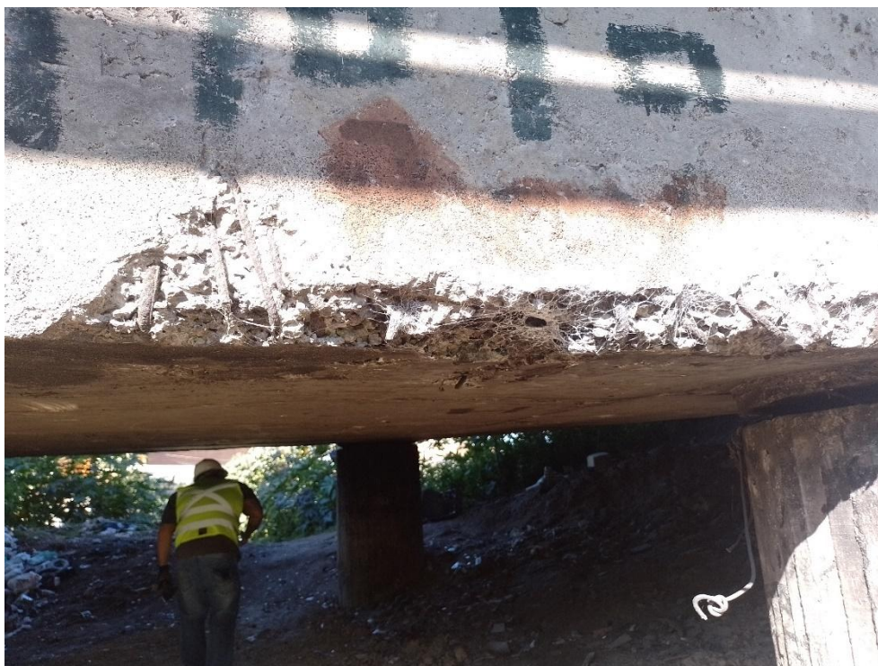
Figura 29 - armadura exposta na laje inferior do caixão
