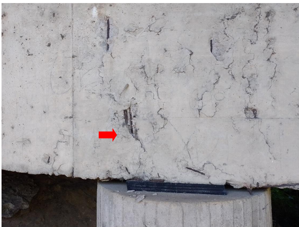
Figura 14 - armadura exposta sobre o pilar P1
