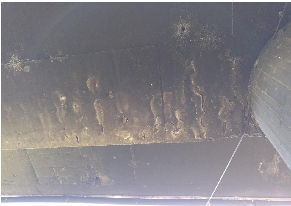
Figura 26 - concreto degradado na parte inferior do caixão e muitas marcas de fuligem
