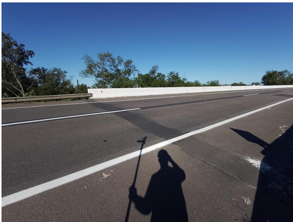
Figura 39 - sem junta de dilatação no encontro E2
