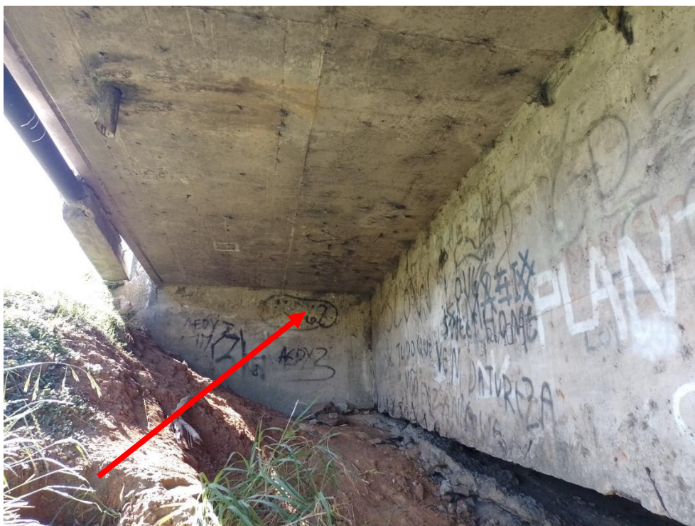
Figura 7 - ala lateral esquerda do encontro E2 - armaduras expostas
