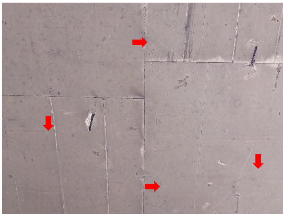
Figura 28 - fissuras na laje inferior do caixão, próximo ao centro do vão
