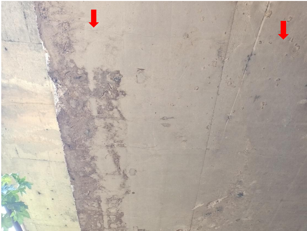
Figura 23 - fissuras na laje inferior do caixão
