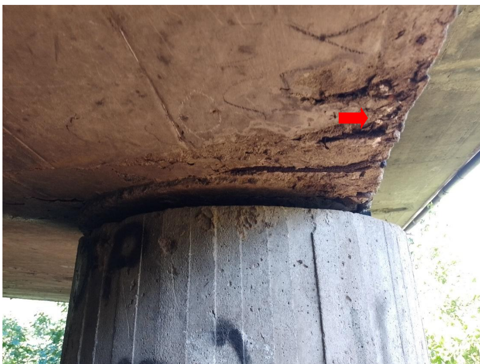
Figura 12 - concreto degradado e armaduras expostas na laje inferior do caixão
