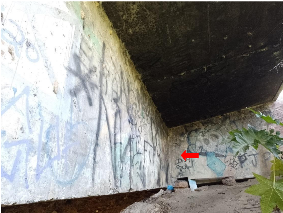
Figura 24 - cortina E2 LD apresenta armaduras expostas
