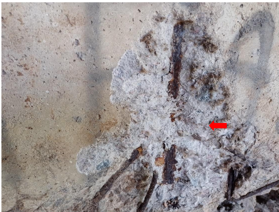
Figura 17 - armadura corroída, com perda de seção, no caixão
