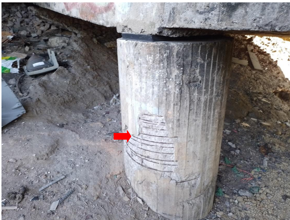
Figura 13 - armadura expostas no P2
